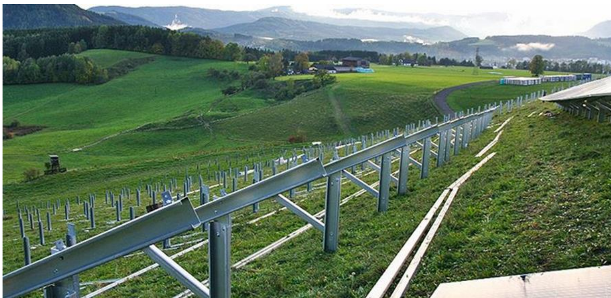
Zdjęcie 3. Konstrukcja przeznaczona do posadowienia paneli fotowoltaicznych.
