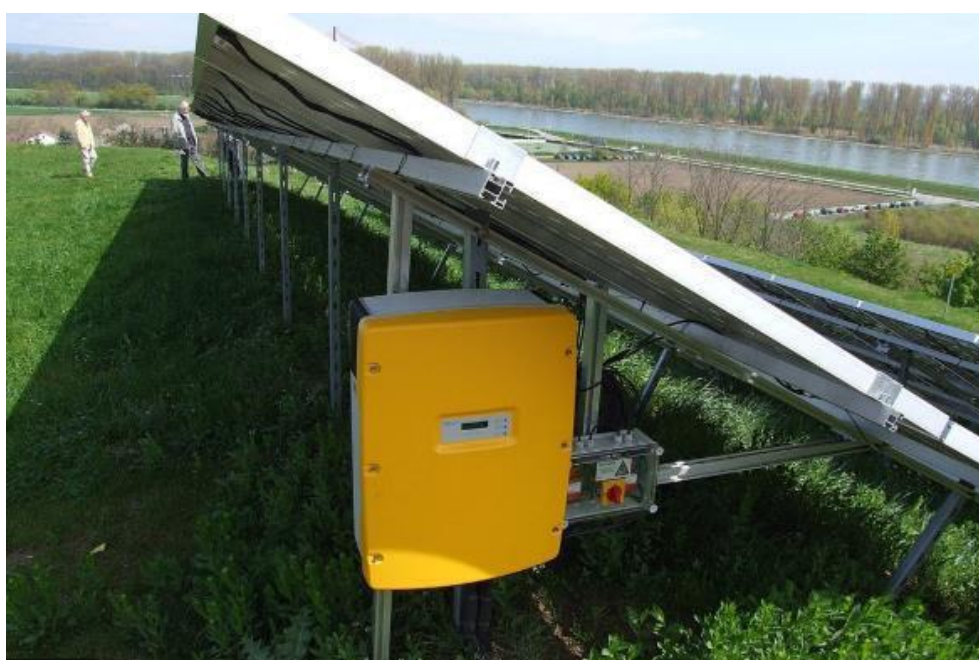
Zdjęcie 4. Przykładowy inwerter farmy fotowoltaicznej.
