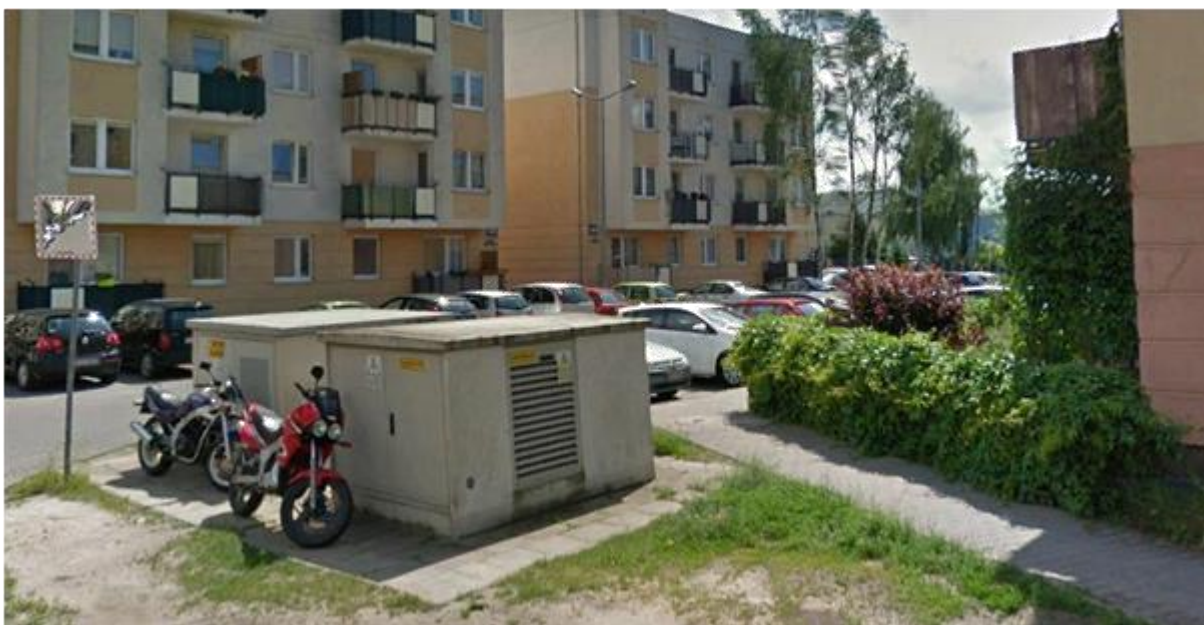
Zdjęcie 6. Stacje transformatorowe w otoczeniu zabudowy.
