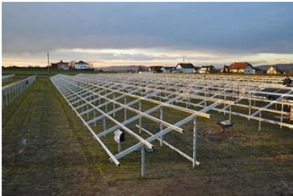
Zdjęcie 8. Szkielety przed montażem paneli, farma solarna NIENBURG 4 MW (Niemcy) (Remor Solar).
