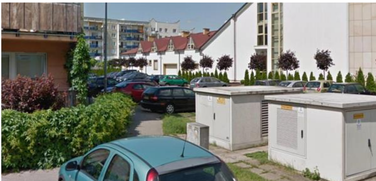
Zdjęcie 5. Standardowe stacje kontenerowe w otoczeniu zabudowy.
