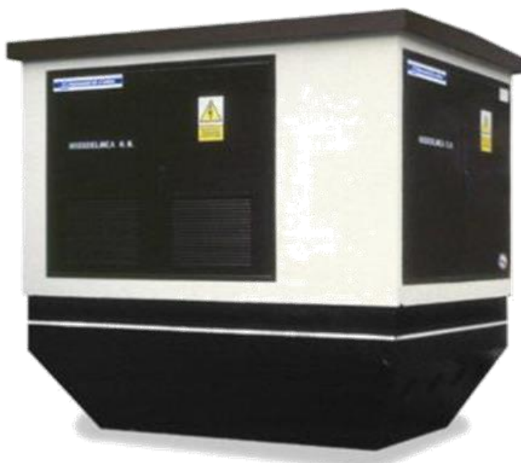
Rysunek 4. Widok na przykładową stację transformatorową.
