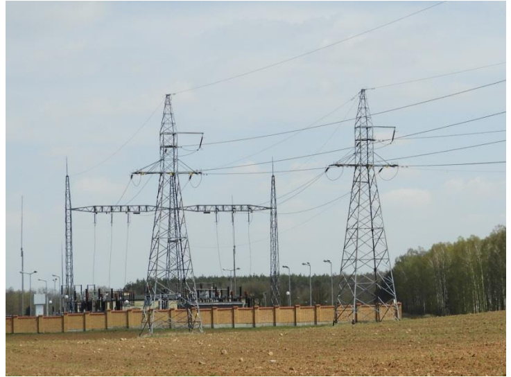
Zdjęcie 53 Główny Punkt Zasilania w Puszczy Miejskiej
