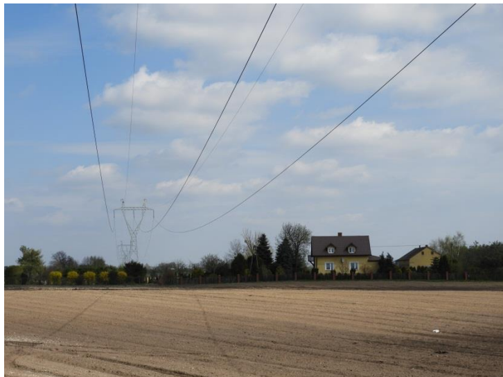
Zdjęcie 55 Linia elektroenergetyczna wysokiego napięcia 220 kV w Godziszewach
