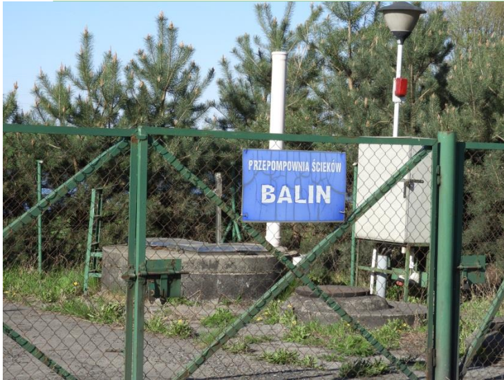
Zdjęcie 51 Przepompownia ścieków w Balinie
